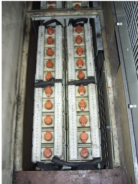
Foto 4 - HLE13 - Plaats van de batterijen - Zicht op 4 bakken in een nis
