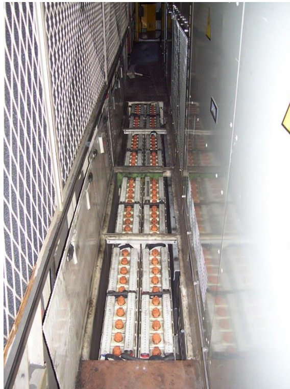
Foto 3 - HLE13 - Plaats van de batterijen - Overzicht
