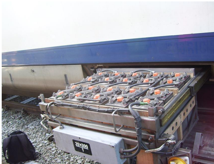
Foto 1 - I11 - Batterijkoffer - Overzicht
