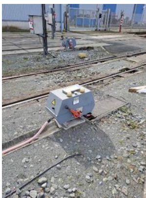
Figure 67 : Installations de préchauffage : boîte de raccordement
