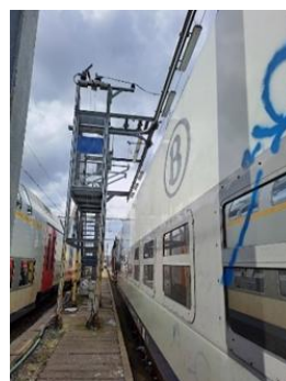
Figure 65 : Installations techniques dans les entrevoies
