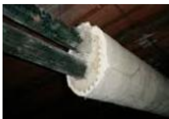
Figure 20 : Plâtre amianté dans l'isolation thermique de conduites
