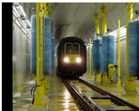
Figure 70 : Installation de lavage des trains – exemple 1
