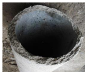
Figure 21 : Amiante-ciment dans les canalisations
