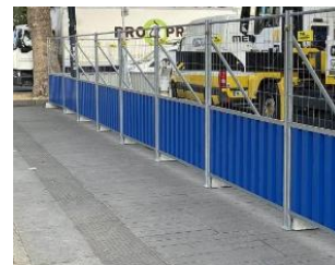
Figure 30 : Barrières détectables par des personnes malvoyantes
