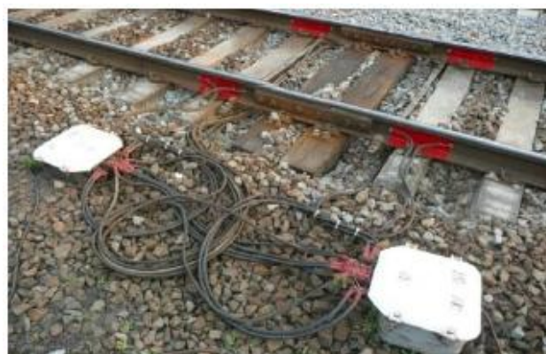
Figure 43 : Collecteur du circuit de retour du courant électrique
