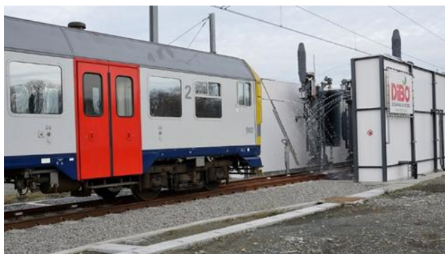
Figure 71 : Installation de lavage des trains – exemple 2
