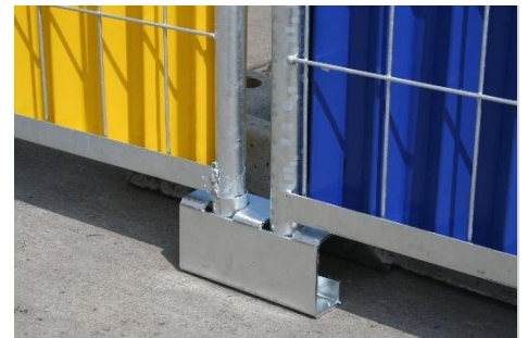
Figure 4 : Barrière rigide, détectable et ne constituant pas d'obstacle aux personnes malvoyantes
