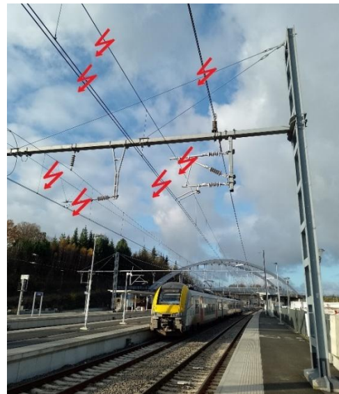
Figure 41 : Illustration des éléments de la caténaire sous tension
