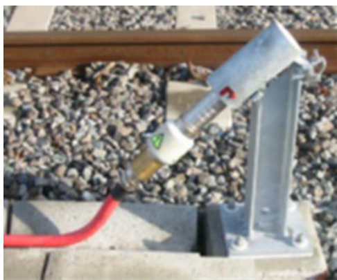
Figure 66 : Installations de préchauffage :le coupleur est dans sa « boîte de repos »
